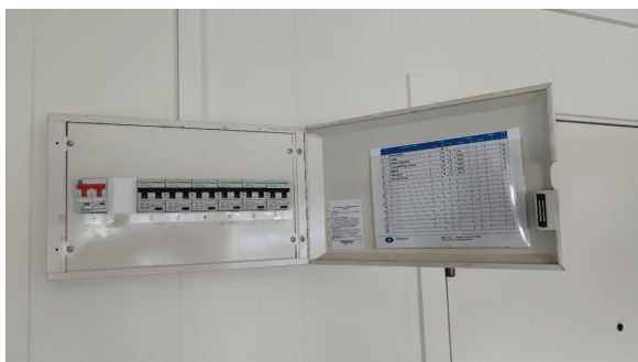
Kontroll av el-skap.
