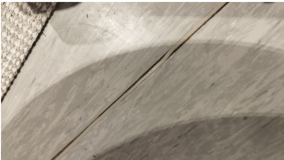
Sprekk i gulvbelegg.
