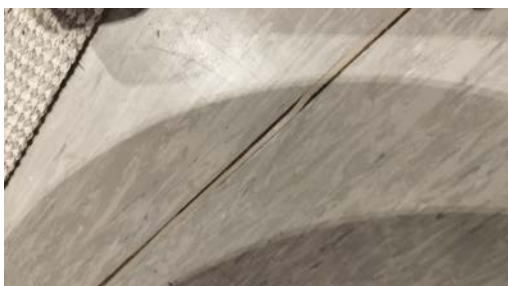
Sprekk i gulvbelegg.
