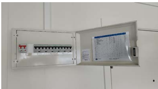
Kontroll av el-skap.
