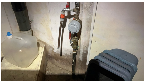
Stoppekran og vannmåler i kjeller.
