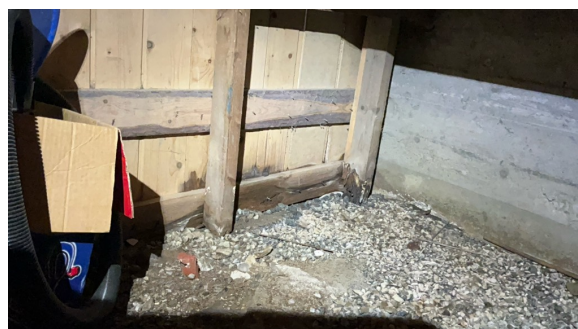
Enkelte råteskader i treverk kjeller.
