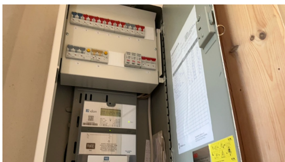
Sikringsskap i soverom.
