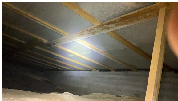
Synlig soppbelegg på stubbeloft. Forholdet gir tilstandsgrad 3.
