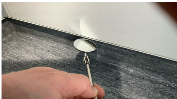
Manglende og sprukket fugemasse mellom sokkelskinne og baderomspanel i dusjsone registrert.
