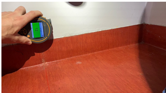
Svelling på plater under utslagsvask. Fuktsøk viste normale verdier.
