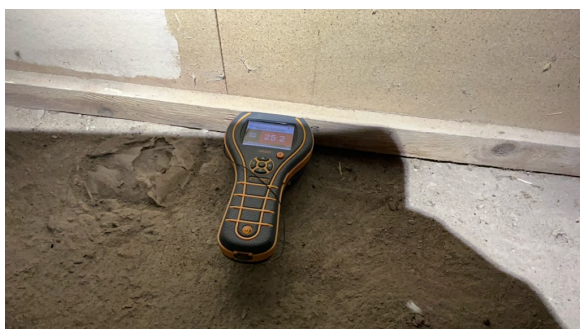
Enkle fuktmålinger på vegg mot terreng viste skadelige verdier for fukt.
