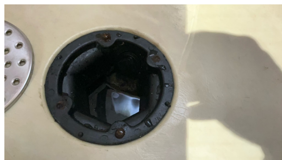
Kontroll av sluk. Klemring er løs.
