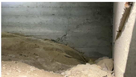
Enkelte sprekkdannelser i grunnmur.
