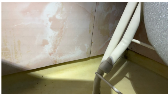
Svelleskader på baderomsplater.
