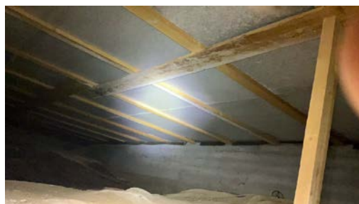
Synlig soppbelegg på stubbeloft. Forholdet gis tilstandsgrad 3.
