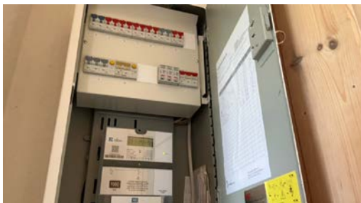
Sikringsskap i soverom.
