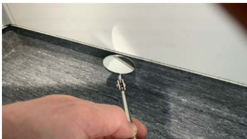
Manglende og sprukket fugemasse mellom sokkelskinne og baderomspanel i dusjsone registrert.
