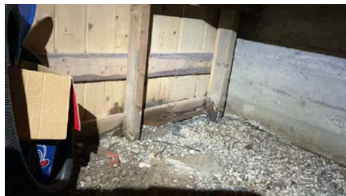
Enkelte råteskader i treverk kjeller.
