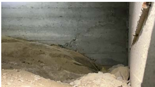
Enkelte sprekkdannelser i grunnmur.
