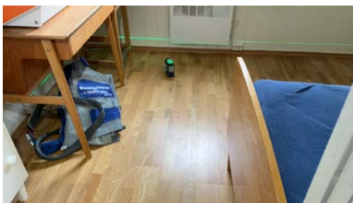
Helningsavvik på ca. 12 mm over en avstand på 2 meter registrert i soverom.
