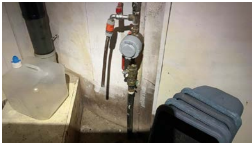
Stoppekran og vannmåler i kjeller.
