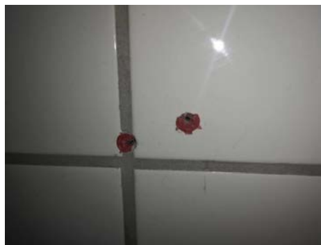
Hull som punkterer tettesjiktet i konstruksjonen.
