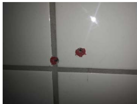
Hull som punkterer tettesjiktet i konstruksjonen.
