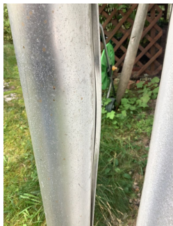
Eksempel på frostspreng på taknedløp.
