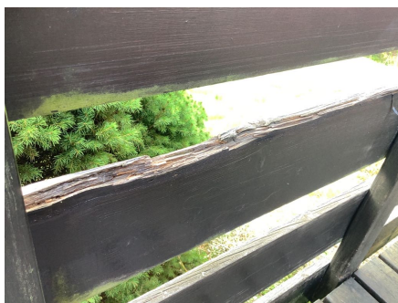
Råte i rekkverkskledning.
