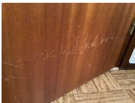
Eksempel på slitasje.
