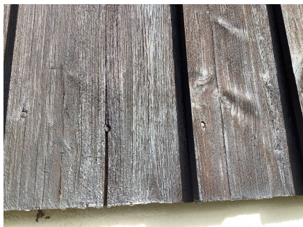
Eksempel på oppsprekking i kledningsbord.
