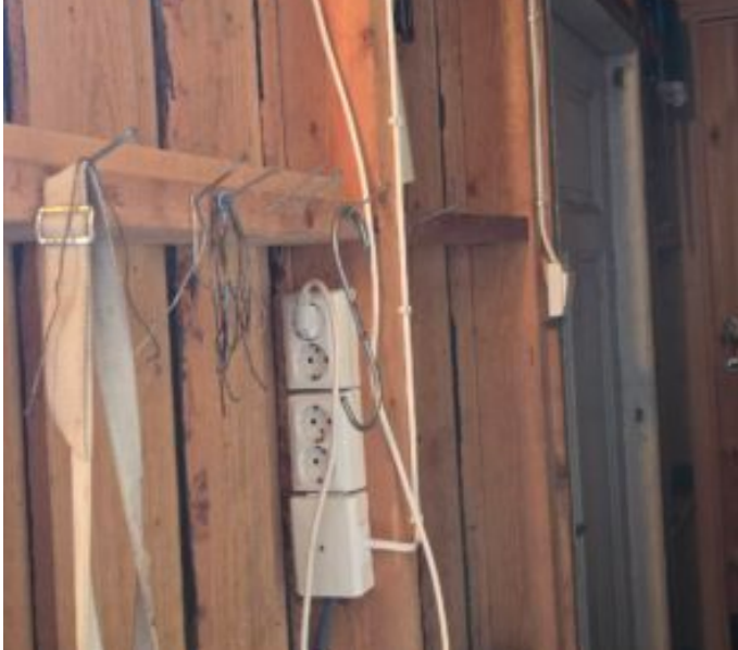
Bilde 1 Utelampe på bevegelig ledning plugg i stikk.
