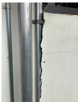
Sprekk og utgliding ved veranda.
