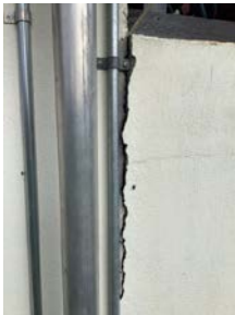
Sprekk og utgliding ved veranda.
