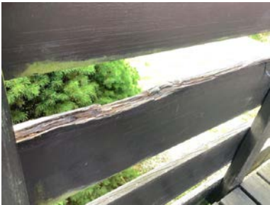
Råte i rekkverkskledning.
