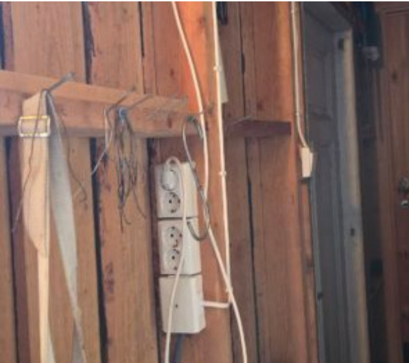
Bilde 1 Utelampe på bevegelig ledning plugg i stikk.
