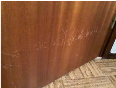
Eksempel på slitasje.
