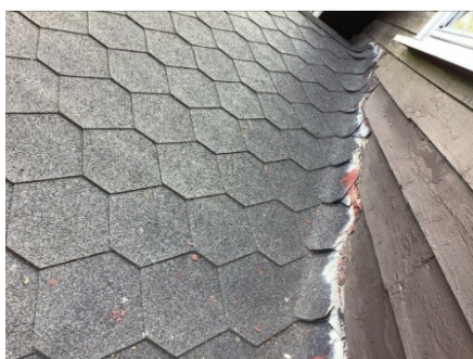
Manglende beslag i overgang vegg/tak.
