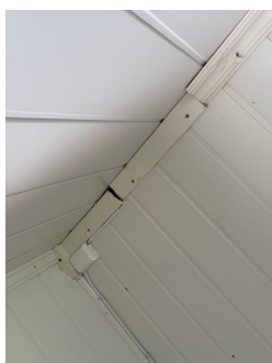
Ufagmessig utførelse av belistning og ferdigstilling.
