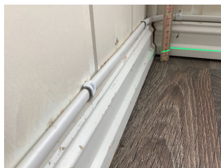
Soverom har høydeforskjell på soverom 25mm.
