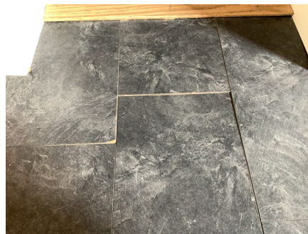
Laminatgulv i kjeller er gått i oppløsning i skjøtene.
