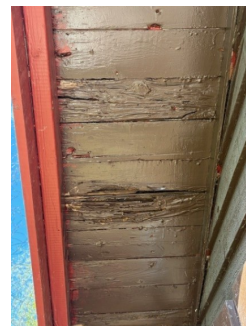
Undertak er skadet ved gesimsutspring på tilbygg.
