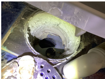
ukjent membran og slukforhøyer
