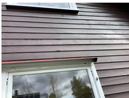
Kledning er værslitt.
