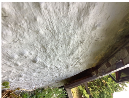
Redusert lufting bak kledning.
