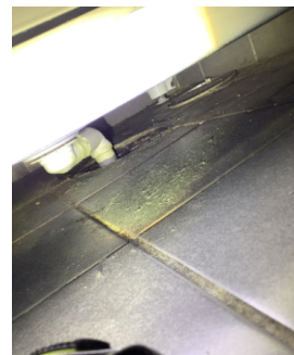
Sluk er plassert under kabinett.
