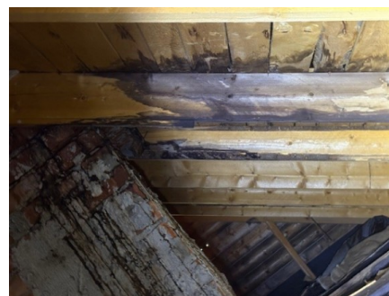
Fuktmerker/skade på bjelker under pipe
