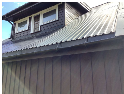
Bøyd takrenne, etter ising på tak.
