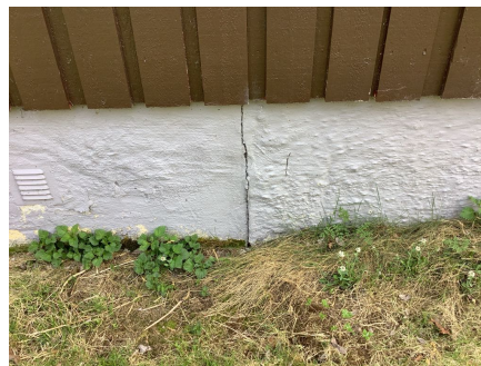
Sprekk i overgang kjeller/krypkjeller og tilbygg flere plasser.
