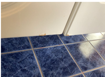
Skapdører har svellet etter fuktpåkjenning.
