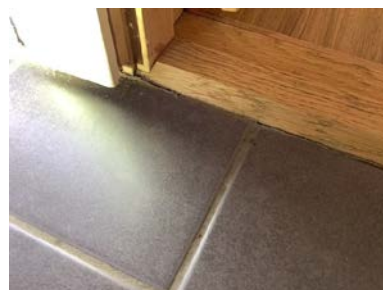
Det er ikke oppkant av membran over flis ved terskel.
