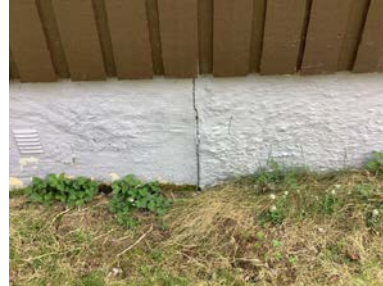
Sprekk i overgang kjeller/krypkjeller og tilbygg flere plasser.
