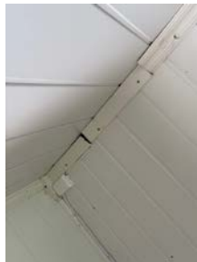
Ufagmessig utførelse av belistning og ferdigstillelse.
