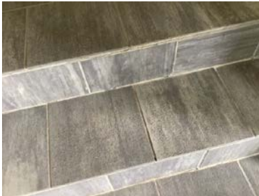
Løse fliser og sprekk i fuger i gang i 1. etasje
