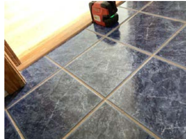
Det er ikke oppkant av membran ved dør.
