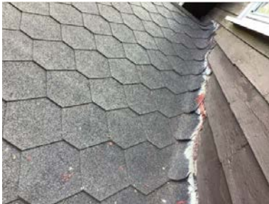
Manglende beslag i overgang vegg/tak.
