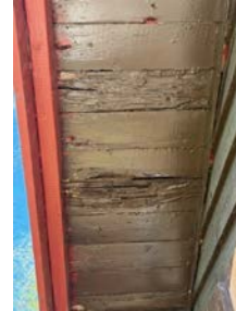
Undertak er skadet ved gesimsutspring på tilbygg.
