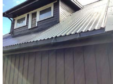
Bøyd takrenne, etter ising på tak.
