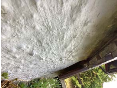
Redusert lufting bak kledning.
