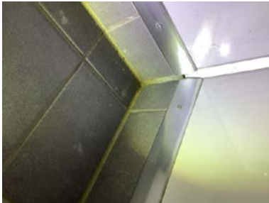
Ikke fagmessig overgang mellom veggplater og sokkelflis.
