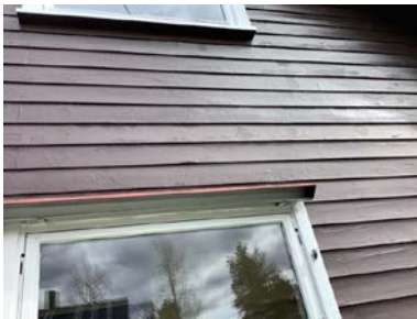
Kledning er værslitt.
