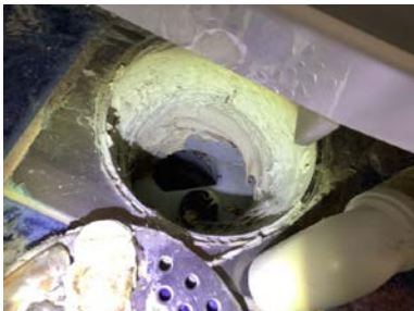
ukjent membran og slukforhøyer
