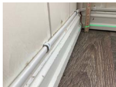
Soverom har høydeforskjell på soverom 25mm.
