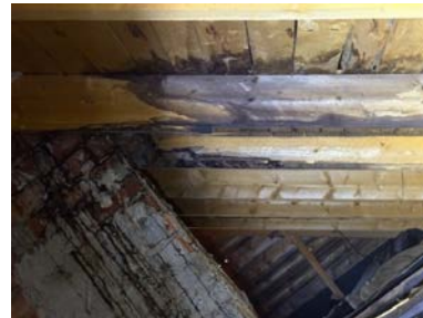
Fuktmerker/skade på bjelker under pipe
