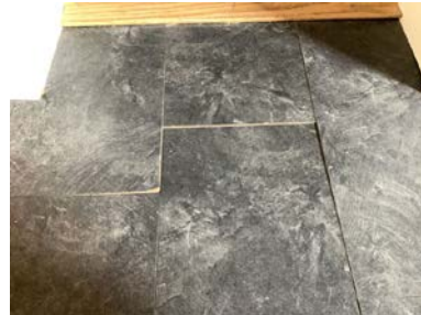
Laminatgulv i kjeller er gått i oppløsning i skjøtene.
