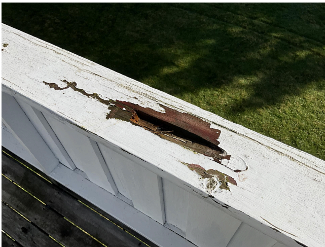
Råte i øverste bord på rekkverk.
