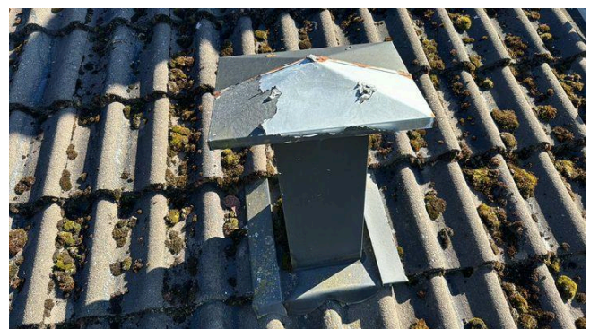
Bilde av takstein med mose og luftehatt med avflasset belegg.
