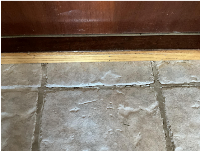
Bilde av sprekk i fuger ved ytterdør.
