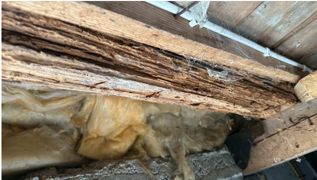
Bilde av råte i bjelkelaget i kjeller.
