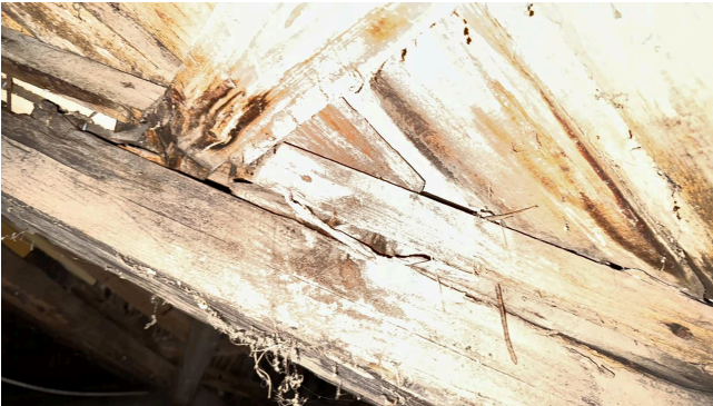
Bilde av råte i takkonstruksjon på loft.
