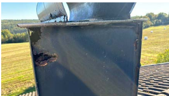
Bilde av pipebeslaget med mye rust
