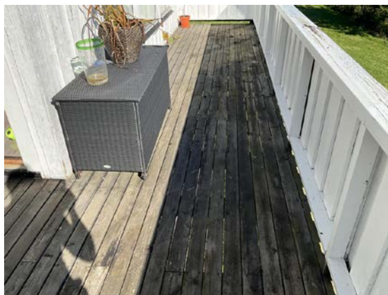
Det er en del slitasje gjennomgående på hele terrassen.
