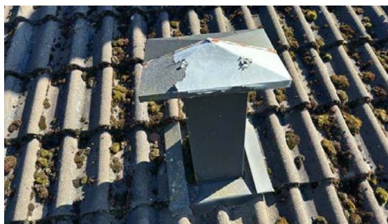
Bilde av takstein med mose og luftehatt med avflasket belegg.
