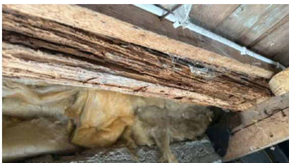
Bilde av råte i bjelkelaget i kjeller.
