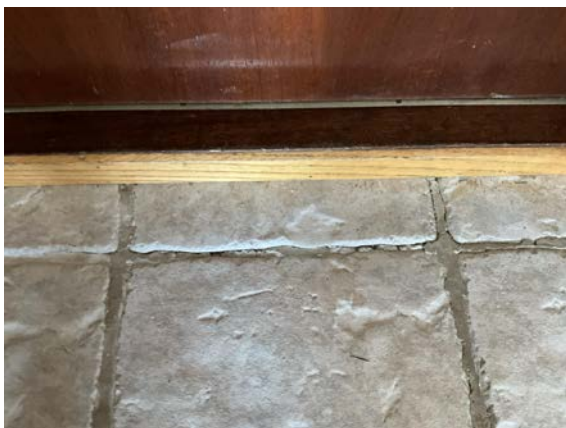
Bilde av sprekk i fuger ved ytterdør.
