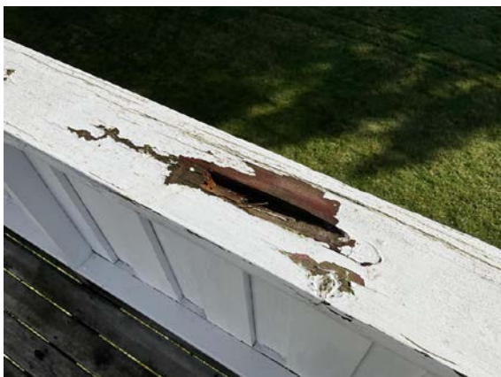
Råte i øverste bord på rekkverk.
