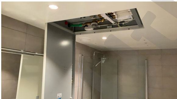
Rørpropp i innvendig tak i bad.
