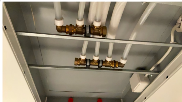
Stoppekraner er i koblingspunkt i tak i våtrom.
