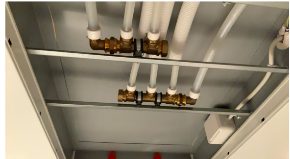
Stoppekraner er i koblingspunkt i tak i våtrom.
