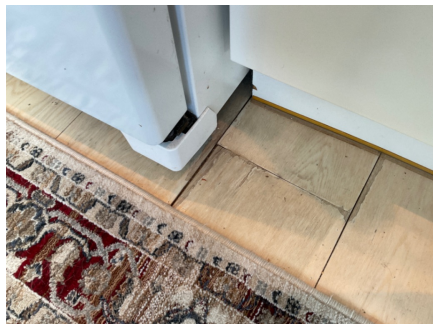
Svelling i gulv i gulv.
