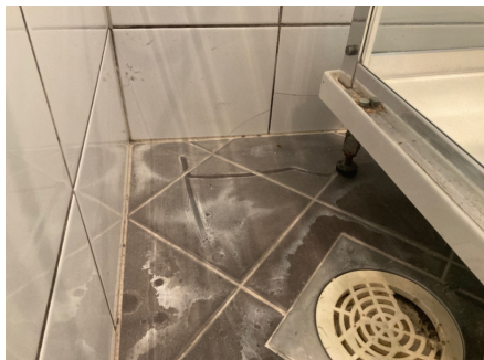
Sprekk i flis i våt sone.
