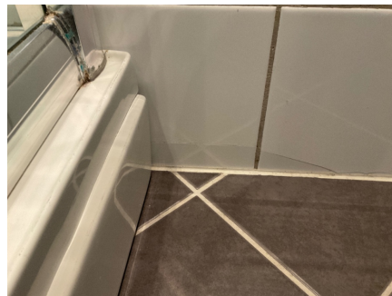
Sprekk i flis på vegg
