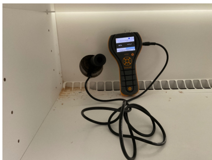
Fuktmåling i utforet vegg under bakkenivå
