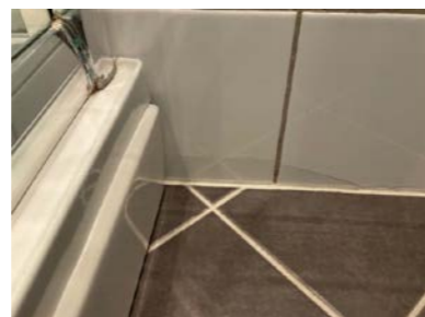
Sprekk i flis på vegg
