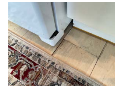
Svelling i gulv i gulv.
