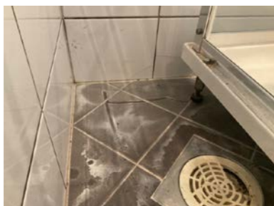
Sprekk i flis i våt sone.
