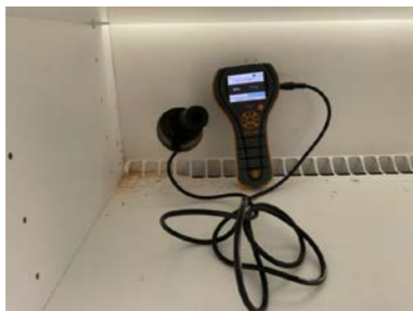
Fuktmåling i utforet vegg under bakkenivå
