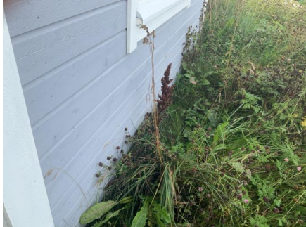
Gress bør fjernes fra husveggen. Forkorter brukstid på trekledning.
