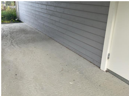
Lav høyde mot grunnen, ikke tilfredsstillende tiluftsstrøm bak kledning.
