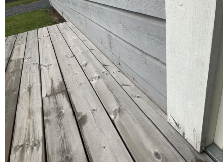
Kledning er malingsslitt mot vest ved terrasseplattung.
