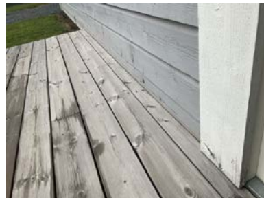
Kledning er malingslitt mot vest ved terrasseplattning.
