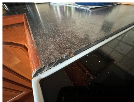
Skader på side benkeplate ved komfyr
