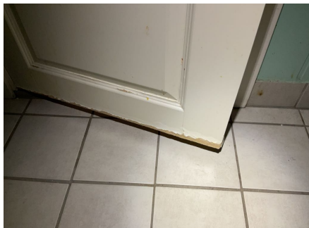
Fuktskader på dør til bad.
