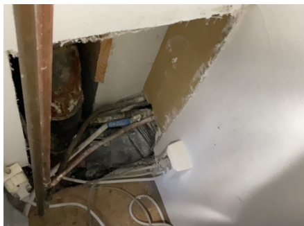
Stoppekran plassert på kjøkken.
