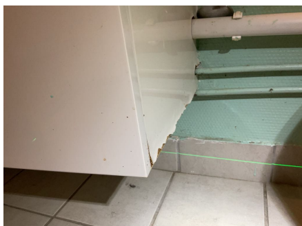
Fuktskader på innredning.
