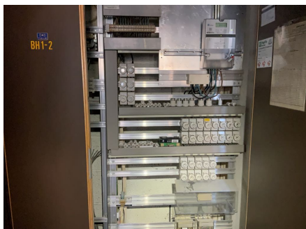
Sikringstavle plassert i gang.
