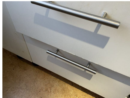
Svelling på innredning.
