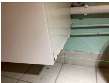
Fuktskader på innredning.
