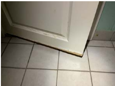
Fuktskader på dør til bad.
