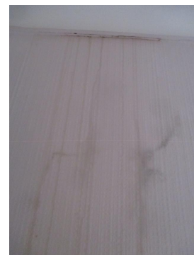
Fuktmerker ved pipe på loftet.
