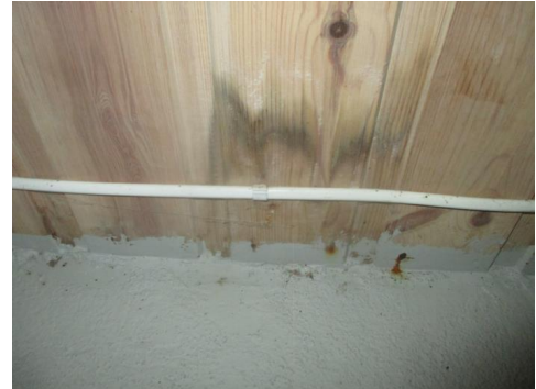
Oppsug av fuktighet i panel.
