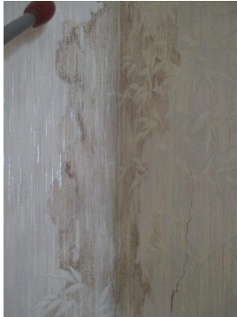
Fuktmerker på tapet ved pipe i hall.
