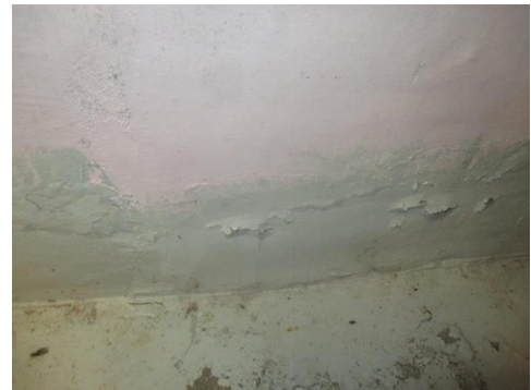
Fuktvandring i nedre del av grunnmur.
