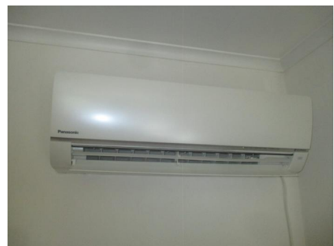
Varmepumpe i stue.
