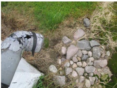
Taknedløp må ledes bort i fra grunnmur.
