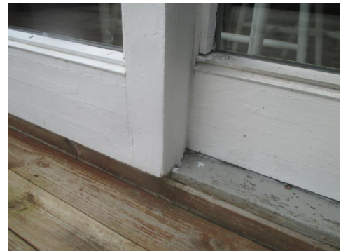
Skyvedør har fått en del utvendig slitasje.
