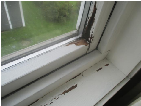
Maling løsnet på grunn av kondensering.
