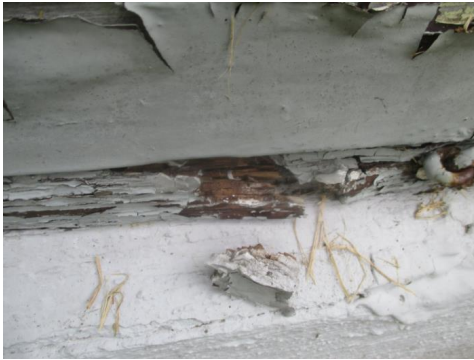
Råteskader på karm.
