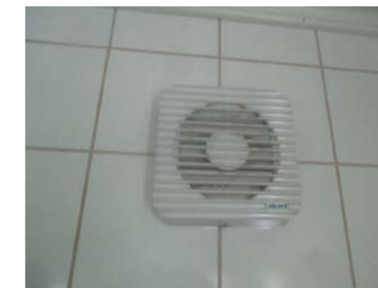
Vifte i ytterveggen.
