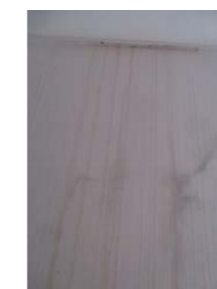
Fuktmerker ved pipe på loftet.
