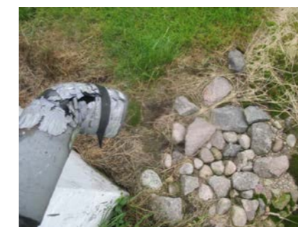
Taknedløp må ledes bort i fra grunnmur.
