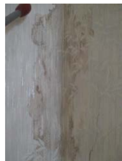
Fuktmerker på tapet ved pipe i hall.
