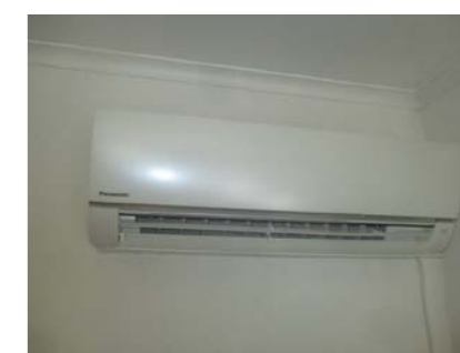
Varmepumpe i stue.
