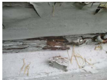
Råteskader på karm.
