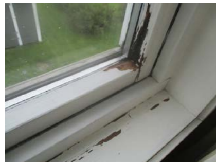
Maling løsnet på grunn av kondensering.
