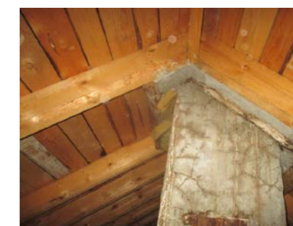
Takgjennomføring for pipe.
