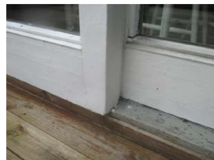
Skyvedør har fått en del utvendig slitasje.
