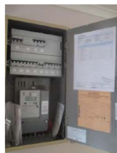
Sikringsskapet er plassert i gangen på loftet.
