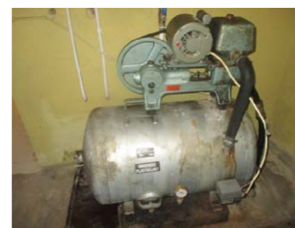
Eldre pumpe til brønnvann.
