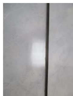
Ytterste belegget på våtromsplater har løsnet på vegg i mot gangen.
