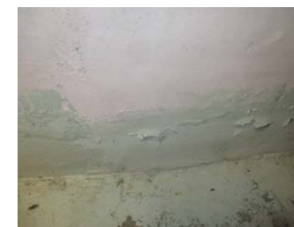
Fuktvandring i nedre del av grunnmur.
