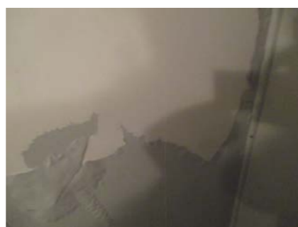
Skadet skillevegg i mot toalettrom
