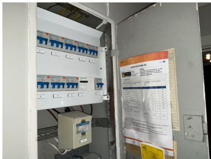
Automatsikringer i sikringskap plassert i entre.
