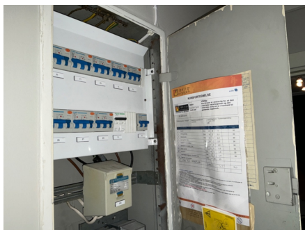
Automatsikringer i sikringskap plassert i entre.
