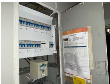
Automatsikringer i sikringsskap plassert i entre.
