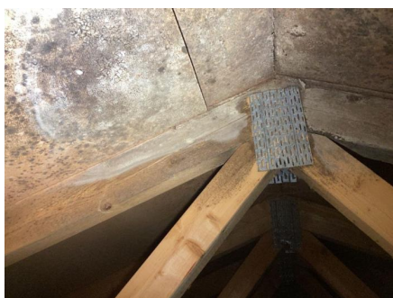
Svertesopp i undertak og takstoler i nærheten av luftekanaler.
