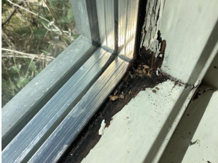
Stuevindu med råteskade.
