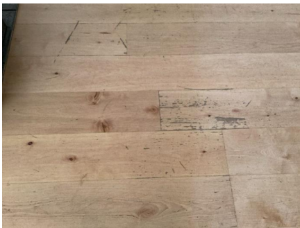
Skade i laminatgulv stue.
