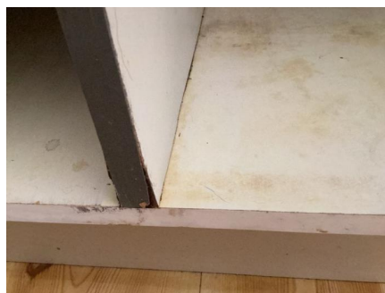
Slitasje og fuktskde på skapskråg under oppvasbenk.
