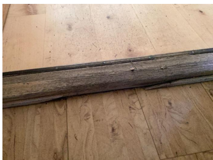
Stor slitasje på terskel til entredør.
