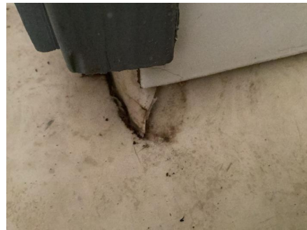
Utett gulvbelegg ved dørterskel.
