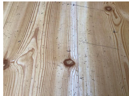
Skade i belegg kjøkkengulv.
