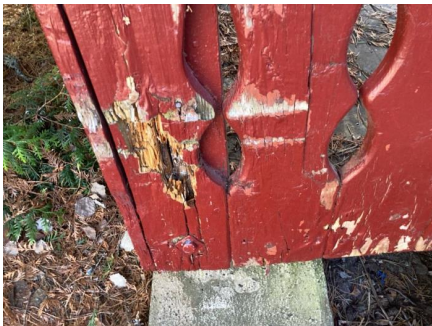
Råteskade i rekkverk.
