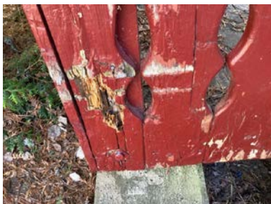
Råteskade i rekkverk.
