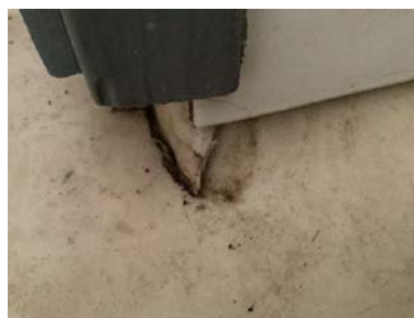
Utett gulvbelegg ved dørterskel.
