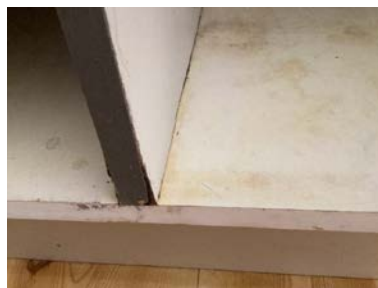
Slitasje og fuktskde på skapskråg under oppvasbenk.
