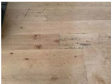
Skade i laminatgulv stue.
