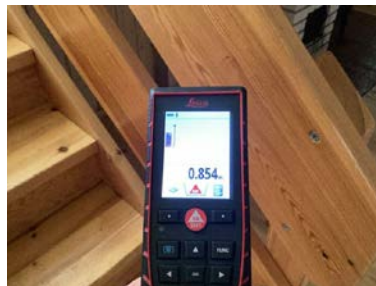
Høyde på rekkverk 85 cm.
