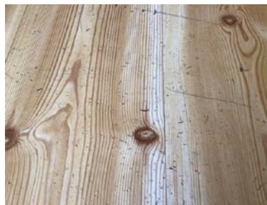
Skade i belegg kjøkkengulv.
