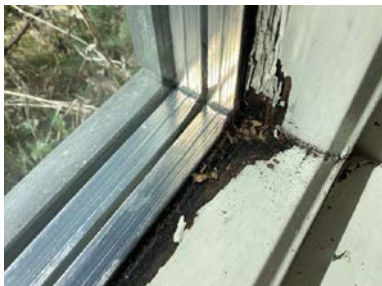
Stuevindu med råteskade.
