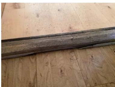
Stor slitasje på terskel til entredør.
