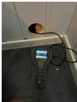
Fuktmåling i utforet vegg viste fuktnivå over normalt.
