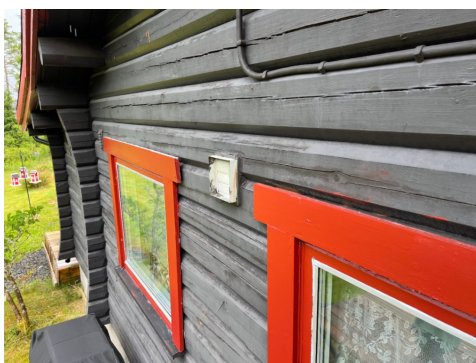
Manglende vannbrettbeslag over vinduer.
