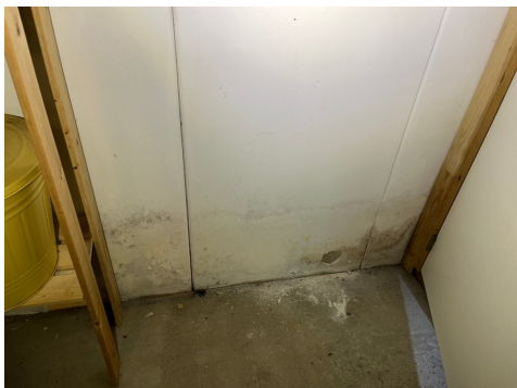
Synlige tegn på fukt.
