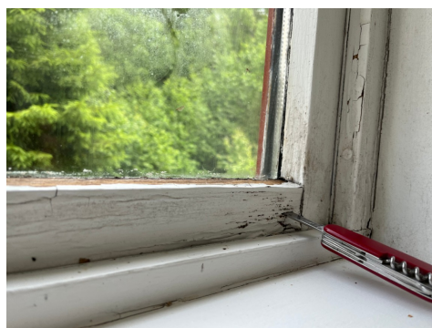
Råte i vindusrammer.
