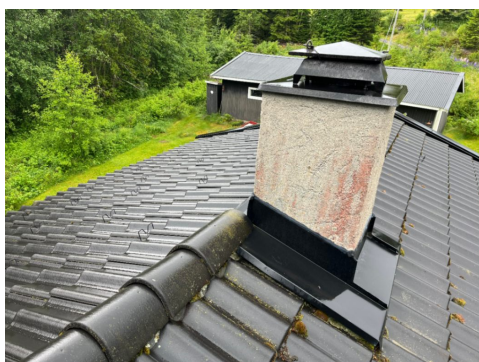
Manglende stigetrinn til pipe.
