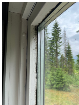
Svertesopp på vinduer tyder på manglende ventilering.
