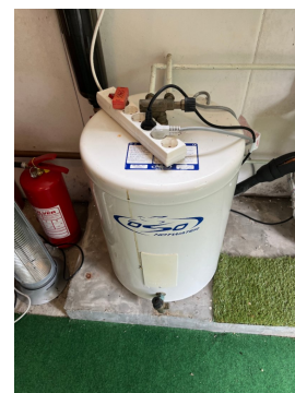
Varmtvannsbereder i underetasje.
