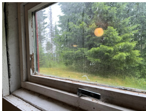
Slitasje på vinduer.
