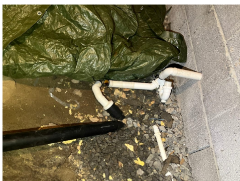
Frakoblet avløpsrør i uinnredet rom underetasje.
