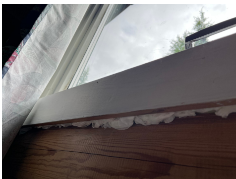
Vindu tettet med papir bak lister.
