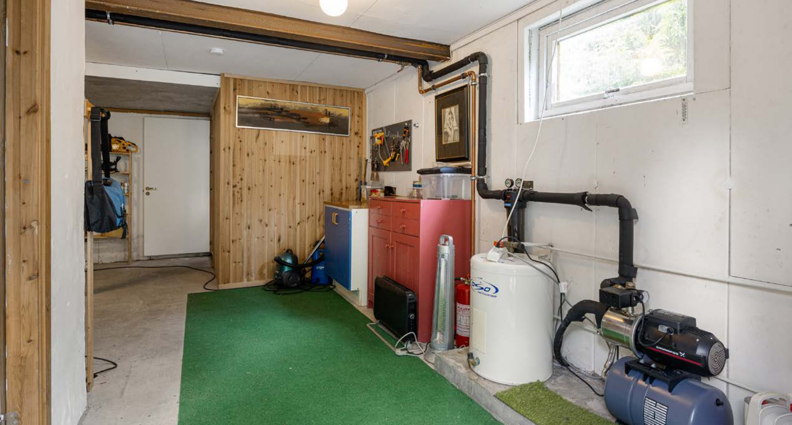
Hytta har oppbevaring- og lagringsplass i kjelleren. Her er også varmtvannsberederen plassert.
