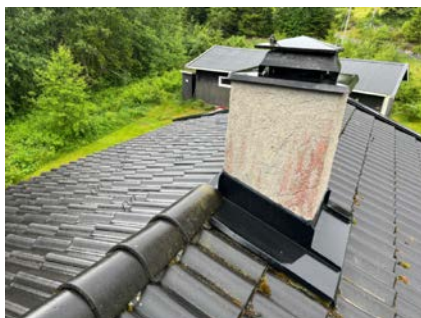
Manglende stigetrinn til pipe.
