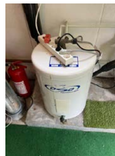
Varmtvannsbereder i underetasje.
