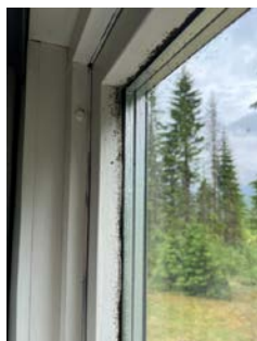
Svertesopp på vinduer tyder på manglende ventilering.
