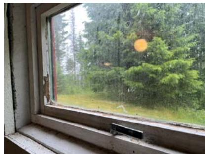
Slitasje på vinduer.
