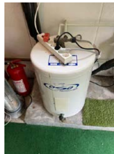
Varmtvannsbereder i underetasje.
