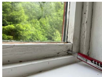
Råte i vindusrammer.
