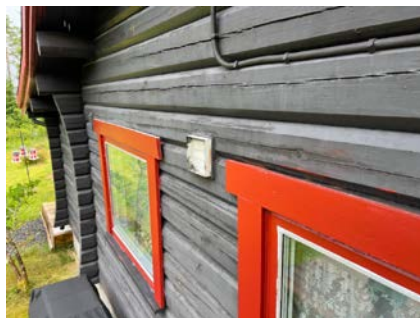
Manglende vannbrettbeslag over vinduer.
