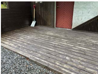
Platting ved underetasje må utbedres.
