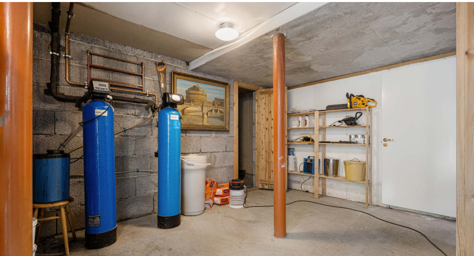
Hytta har ikke innlagt offentlig vann og avløp, men vann fra brønn og privat avløpsordning. I uinnredet rom i kjelleren er trykktank og renseanlegg plassert.
