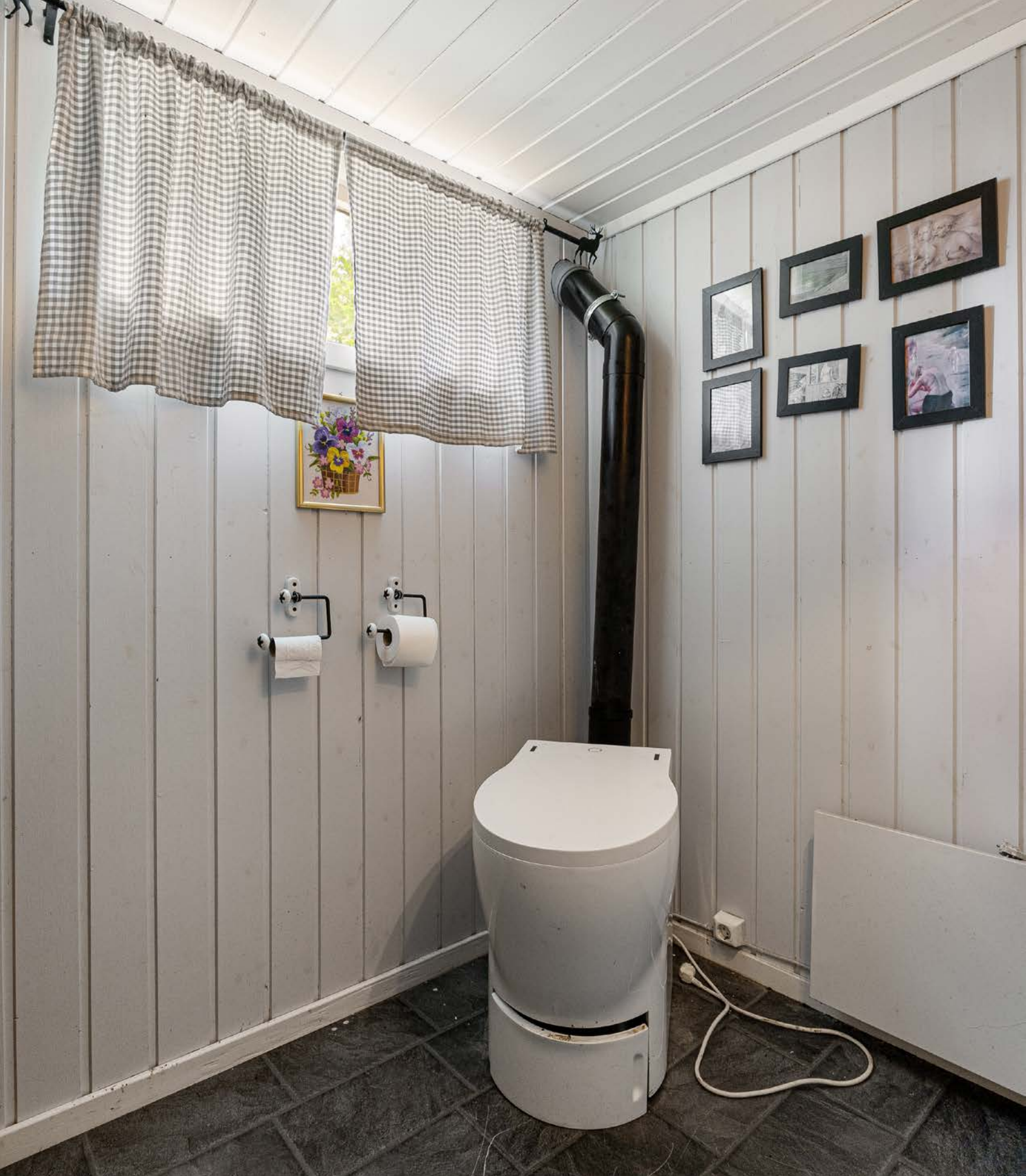
På toalettrommet er det et forbrenningstoalett fra 2021.
