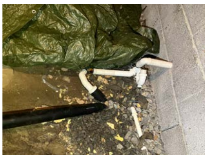
Frakoblet avløpsrør i uinnredet rom underetasje.
