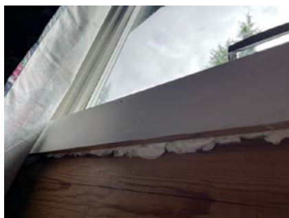
Vindu tettet med papir bak lister.
