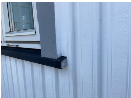
Kledning som er ført helt ned mot vannbrett
