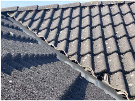
Knekt og manglende takstein i gradrenne
