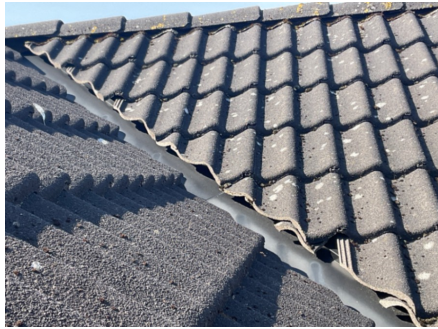
Knekt og manglende takstein i gradrenne
