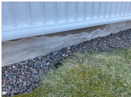
Skjoldet og saltutslag på fundament.
