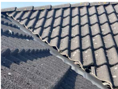
Knekt og manglende takstein i gradrenne
