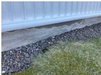
Skjoldet og saltutslag på fundament.
