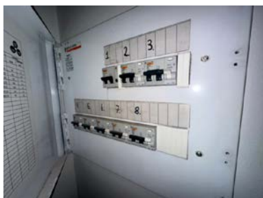
Sikringsskap med automatsikringer.
