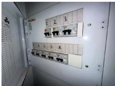
Sikringsskap med automatsikringer.
