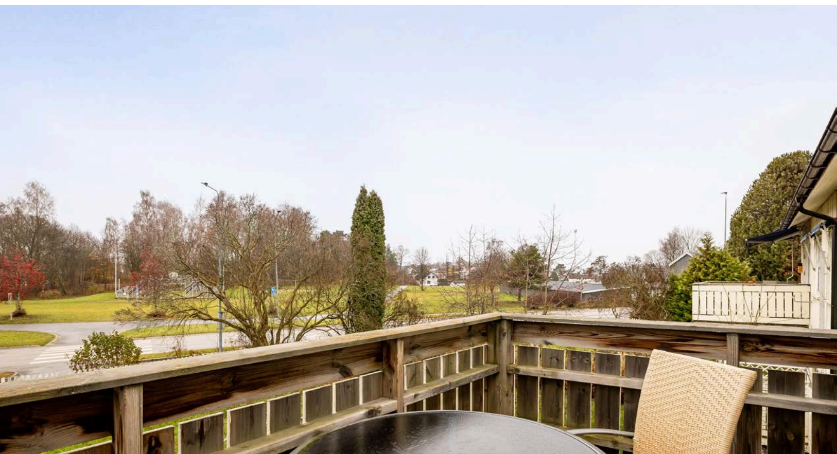
Balkongen som var ny i 2012 har terrassebord på golv og plass til sittegruppe. Beliggenheten mot syd sørger for gode solforhold.
