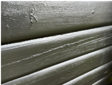
Noe stedvis mindre oppsprekning.
