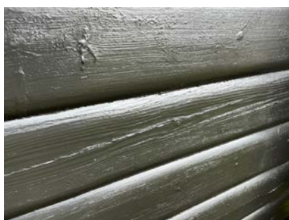
Noe stedvis mindre oppsprekning.
