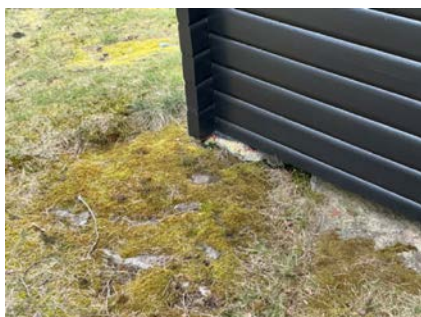
Oppsyn, laft ligger nærme terreng som kan medføre fukttoppsug.
