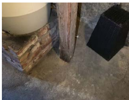
stolpe med fuktoppug mot betong
