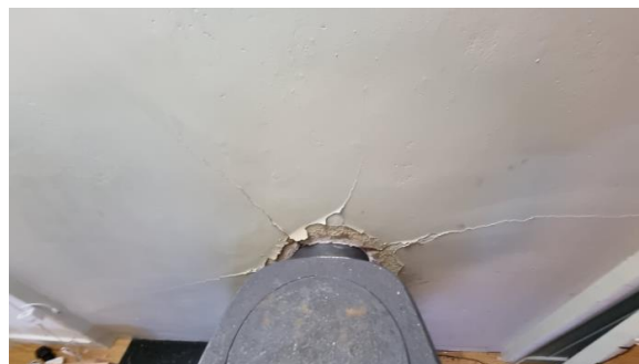
Det er sprekk i pipe. Kjelleretasje.
