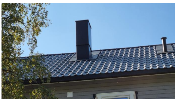
Det er ikke snøfangere på taket.
