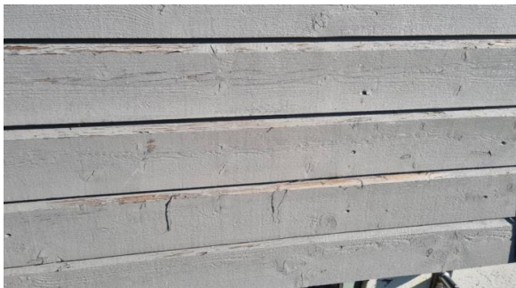
Kledningen er værslitt.
