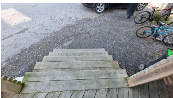
Trapp til inngangsdør i 1. etasjen mangler tilfredsstillende rekkverk på begge sider.
