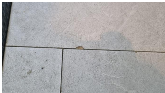
Skade i gulv i vindfang 1. etasje (fellesareal).
