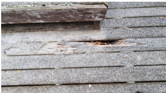
Skade på terrassebord.
