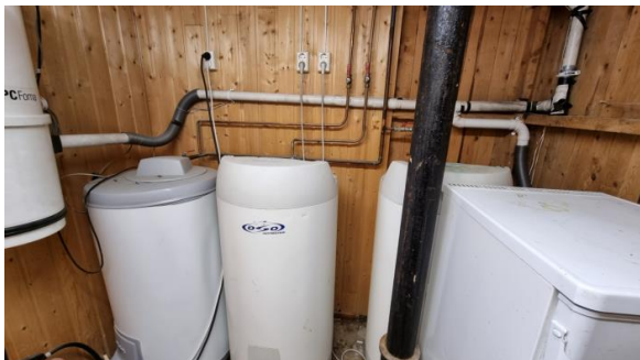
Varmtvannsberedere er tilkoblet via stikk.
