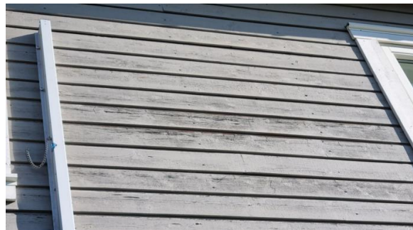
Kledningen er værslitt.
