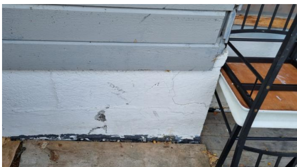
Sprekk i grunnmur på inngangsparti i kjelleretasjen.
