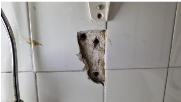
Skade på flis i våtsone.
