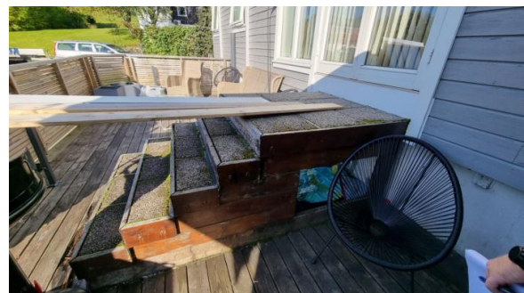
Trapp til terrassedør i 1. etasjen mangler tilfredsstillende rekkverk på begge sider.
