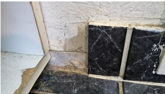
Det mangler sokkelflis.
