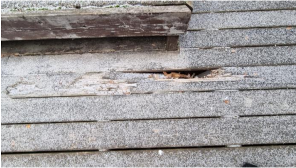
Skade på terrassebord.
