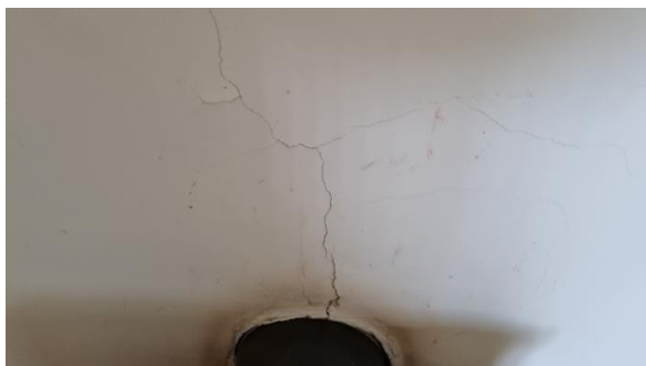
Det er sprekk i pipe. 1. etasje.
