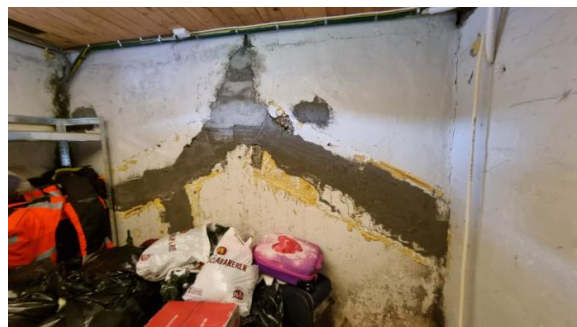
Sprekker i grunnmur som har blitt utbedret av eier.
