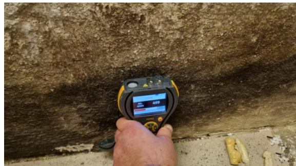
Det ble registrert forhøyde fuktverdier.
