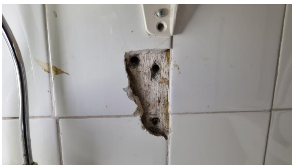
Skade på flis i våtsone.
