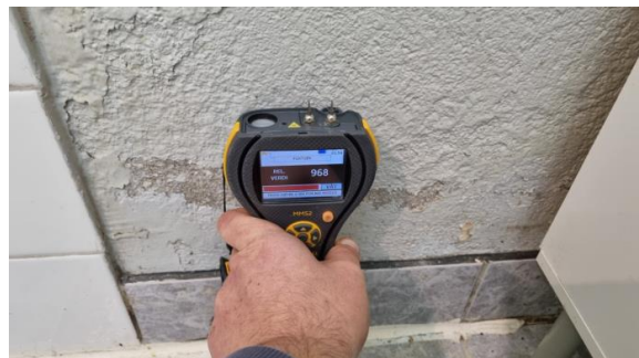
Det ble registrert forhøyde fuktverdier på vegg i våtsone.
