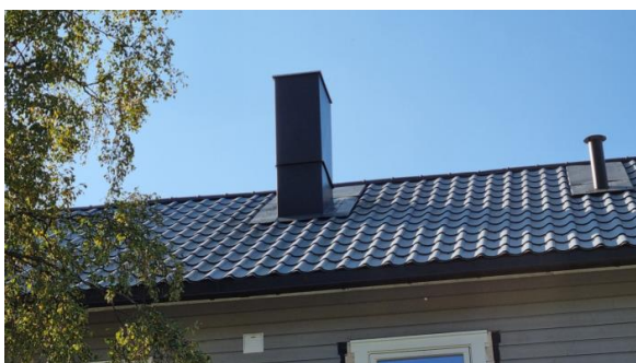
Det er ikke snøfangere på taket.
