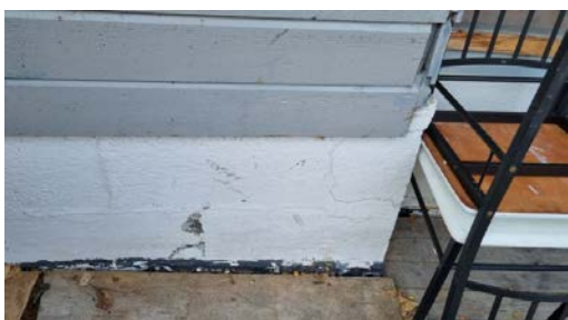
Sprekk i grunnmur på inngangsparti i kjelleretasjen.
