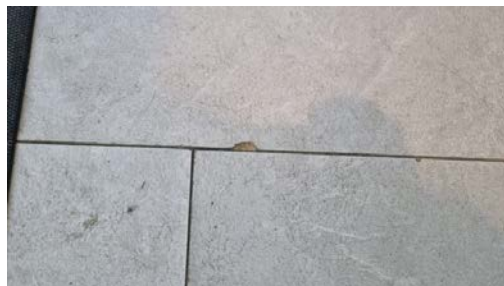
Skade i gulv i vindfang 1. etasje (fellesareal).
