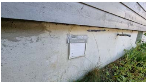
Grunnmursplast og klemlist ligger under terrenget.
