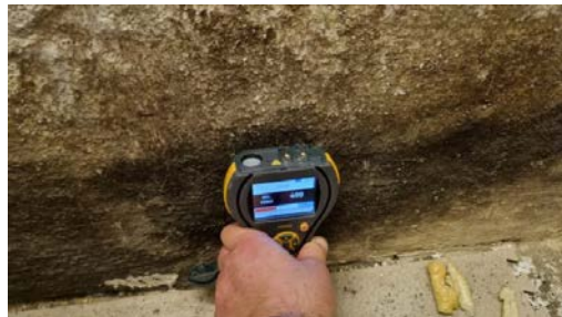
Det ble registrert forhøyde fuktverdier.
