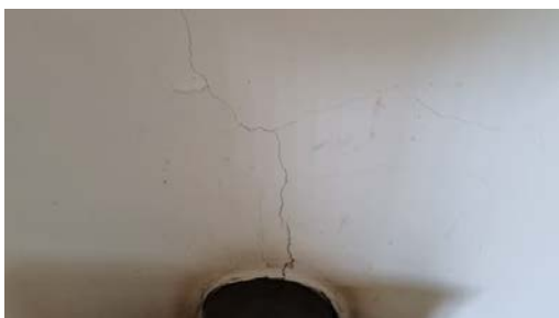
Det er sprekk i pipe. 1. etasje.
