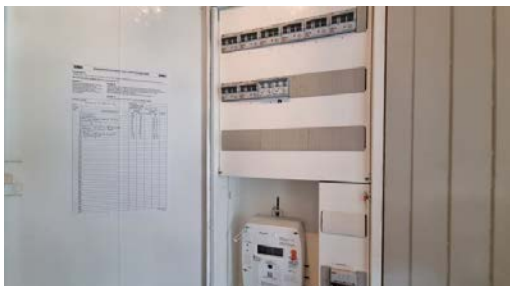
Kontroll av el-skabet i 1. etasje.
