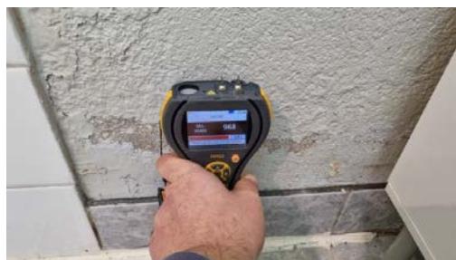
Det ble registrert forhøyde fuktverdier på vegg i våtsone.
