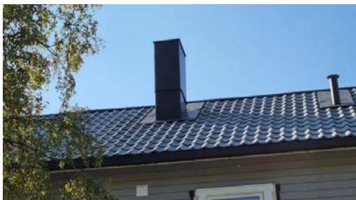
Det er ikke snøfangere på taket.
