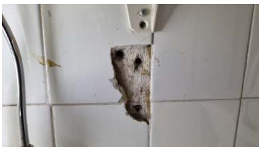
Skade på flis i våtsone.
