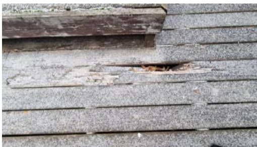
Skade på terrassebord.
