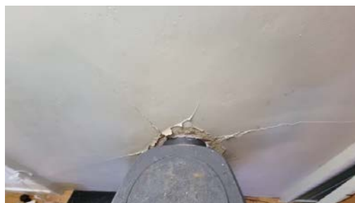
Det er sprekk i pipe. Kjelleretasje.
