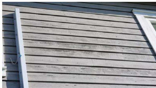
Kledningen er værslitt.
