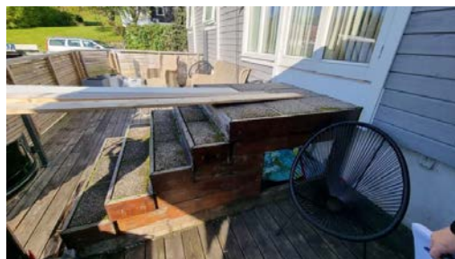
Trapp til terrassedør i 1. etasjen mangler tilfredsstillende rekkverk på begge sider.
