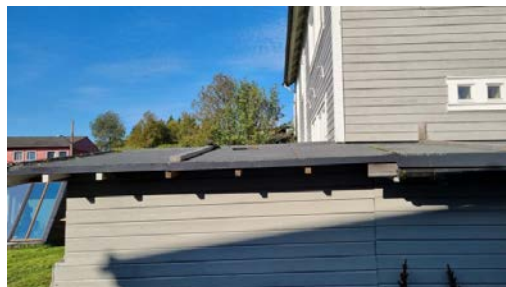
Det mangler takrenne på deler av tak samt at det mangler nedløp der det er etablert takrenne.
