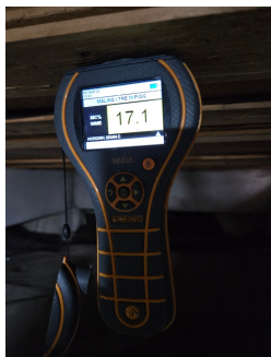
Fuktmåling i treverk i krypkjeller.
