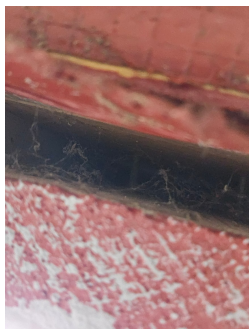
Ingen synlig musesperre bak utvendig k
