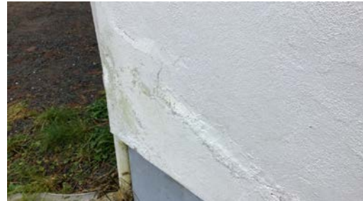
Eksempel på løsnet puss og maling.
