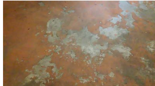
Saltutslag på gulv.
