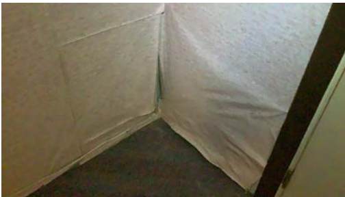
Løst tapet som følge av fukt.
