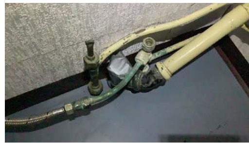
Avløp på toalettrom er tapet over.
