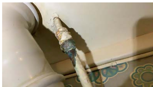
Drypplekkasje på kjøkken.
