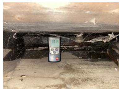
Våt taktro grunnet taklekkasje.
