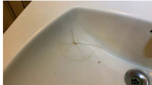
Sprekk i servant.
