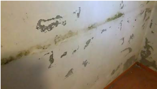
Saltutslag på vegg.
