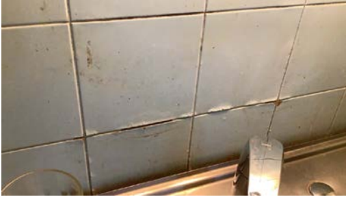
Svellskader i flisimiterte plater.
