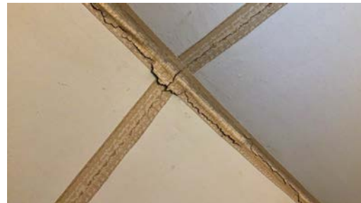
Rift i skjøtebånd i himling.
