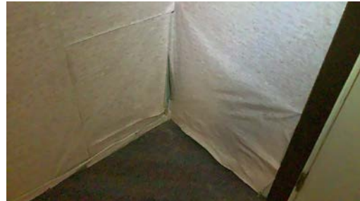
Løst tapet som følge av fukt.
