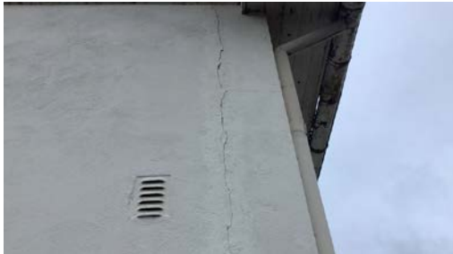
Eksempel på sprekkdannelse.
