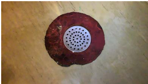
Pålimt mansjett fører til at slukrist ikke lar seg løfte opp.
