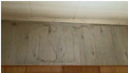
Fuktskjolder i tapet.
