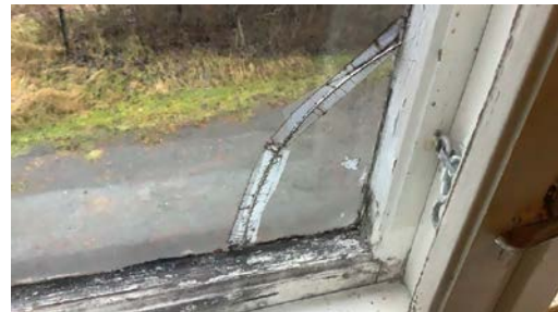
Værslitt vindu med sprukket glass.
