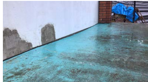
Skjevhet i dekket.
