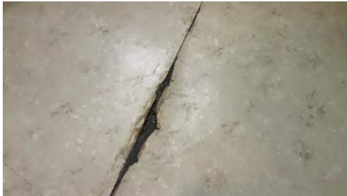
Løst og skadet gulvbelegg.
