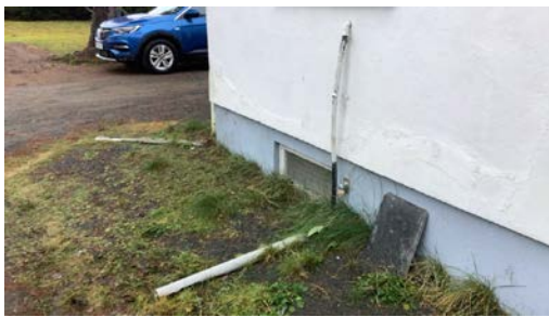
Avløp fra vaskemaskin er ført ut gjennom vegg.
