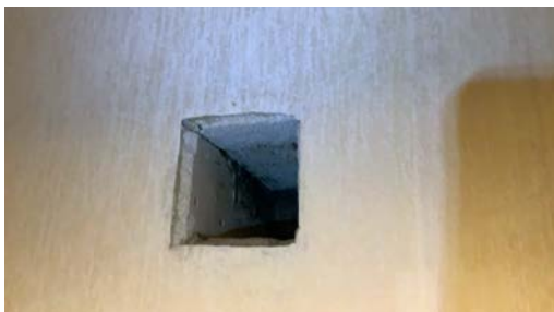
Det mangler deksel på veggventil.
