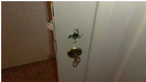
Vrider mangler på dør til bad i kjeller.
