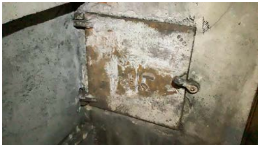
Sotluke tetter ikke tilstrekkelig.
