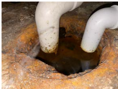
Støpejernsluk uten tettesjikt.
