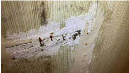
Utett tettesjikt og fuktskadet vegg.
