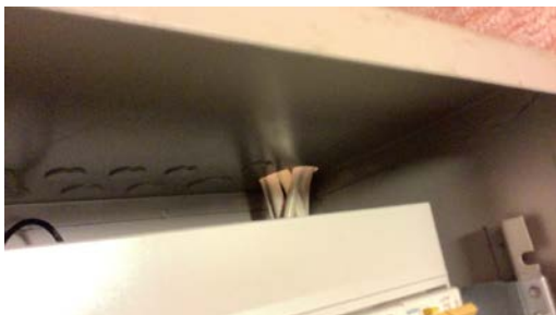
Utett kabelinnføring i sikringsskap.
