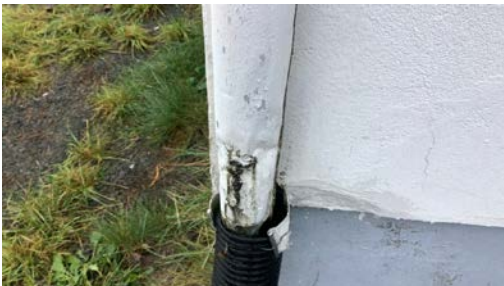
Frostsprengt nedløpsrør, og skadet nedløpsrør.
