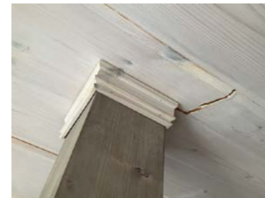
Søyle under mønedrager har presset seg noe opp i taket. Dette har ført til at panel/overflaten i taket har fått skjevheter og panelskjøter glipper.
