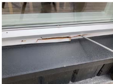
Det er påvist vinduer med fukt/råteskader.
