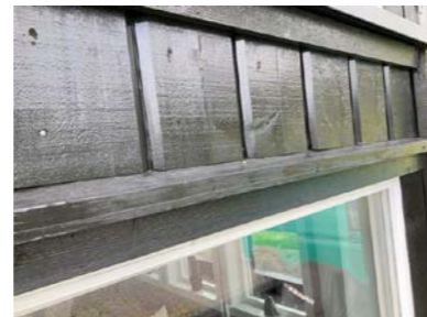
Kledning er ført helt ned mot vannbrett, dette vil føre til fuktopptrekk i endeved.
