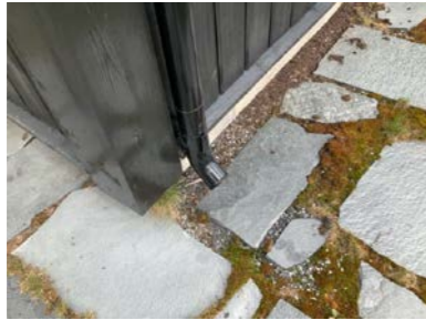
Takvannet ledes ikke vekk fra bygningen.
