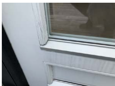
Det registreres utvendig avflassing av overflatebehandling.
