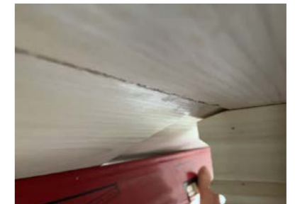
Søyle under mønedrager har presset seg noe opp i taket. Dette har ført til at panel/overflaten i taket har fått skjevheter og panelskjøter glipper.
