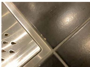
Det registreres enkelte sår/hakk i fliser.
