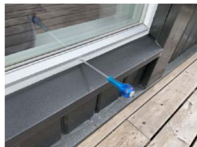
Det er påvist vinduer med fukt/råteskader.
