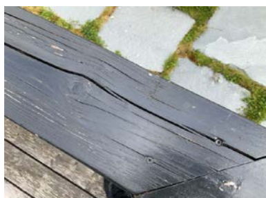
Stedvis sprekker i håndlist.
