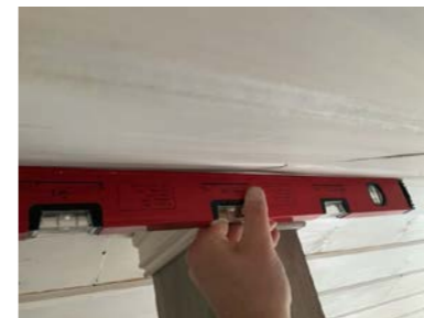
Søyle under mønedrager har presset seg noe opp i taket. Dette har ført til at panel/overflaten i taket har fått skjevheter og panelskjøter glipper.
