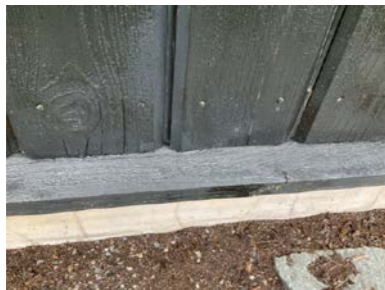
Småsprekker nederst på kledning er registrert.
