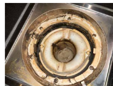
Sluk på befaringdagen.
