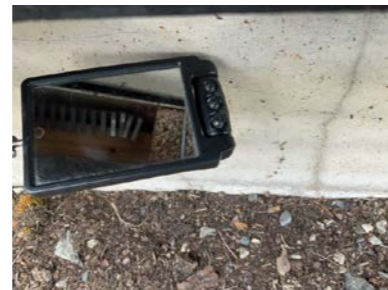
Det er observert glipper / åpninger i overganger / lufting i veggkonstruksjon der skadedyr kan komme inn.
