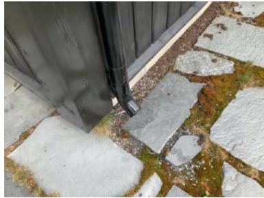
Takvannet ledes ikke vekk fra bygningen.
