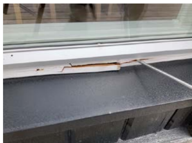
Det er påvist vinduer med fukt/råteskader.
