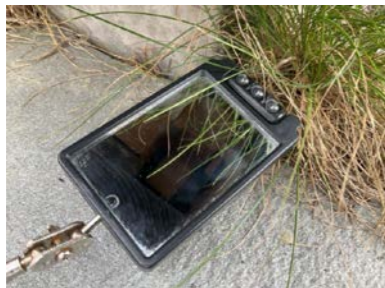
Det er observert glipper / åpninger i overganger / lufting i veggkonstruksjon der skadedyr kan komme inn.
