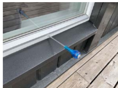
Det er påvist vinduer med fukt/råteskader.
