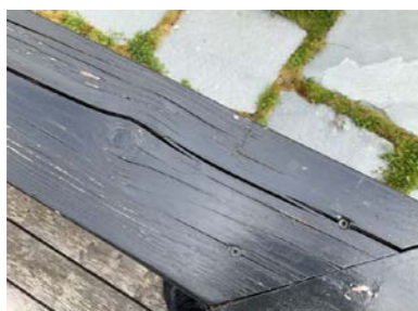
Stedvis sprekker i håndlist.
