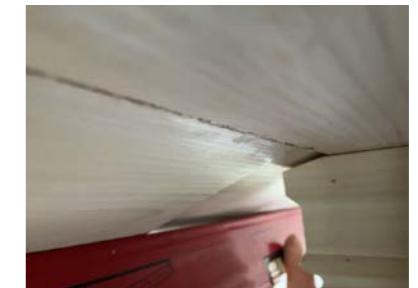
Søyle under mønedrager har presset seg noe opp i taket. Dette har ført til at panel/overflaten i taket har fått skjevheter og panelskjøter glipper.
