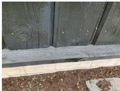
Småsprekker nederst på kledning er registrert.
