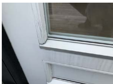
Det registreres utvendig avflassing av overflatebehandling.
