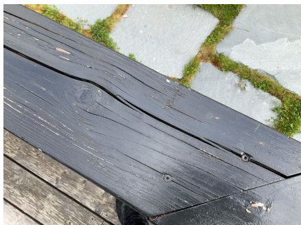
Stedvis sprekker i håndlist.
