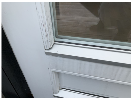
Det registreres utvendig avflassing av overflatebehandling.
