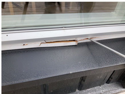
Det er påvist vinduer med fukt/råteskader.
