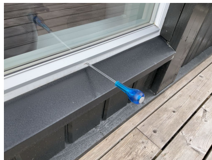
Det er påvist vinduer med fukt/råteskader.
